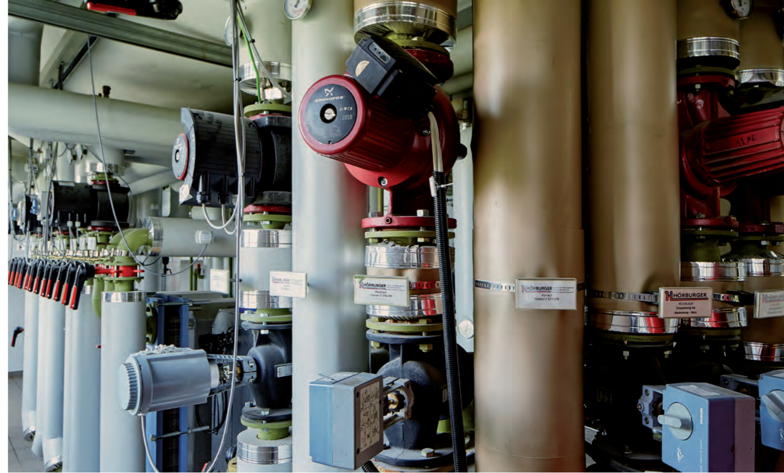
Teil der Wärmepumpenanlage: Aus der nicht mehr nutzbaren Abwärme wird hochwertige Prozesswärme erzeugt.
